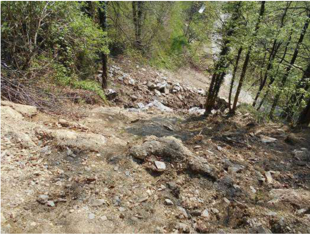
Intervento 1 - Vista da monte dell'area in frana in loc. Moloire
